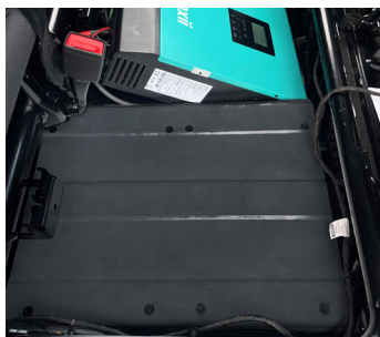
Pack Batterie additionnelle lithium + inverter sous banquette passager
